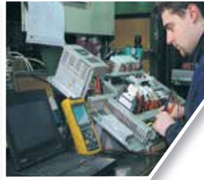
Cableado de cuadro eléctrico Control panel wiring
