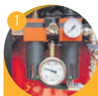
1 Tratamiento de aire
