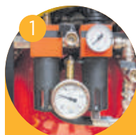
1 Tratamiento de aire
