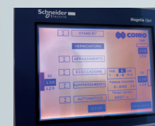
Cuadro eléctrico PLC para corriente cíclica en el Kit de paneles
