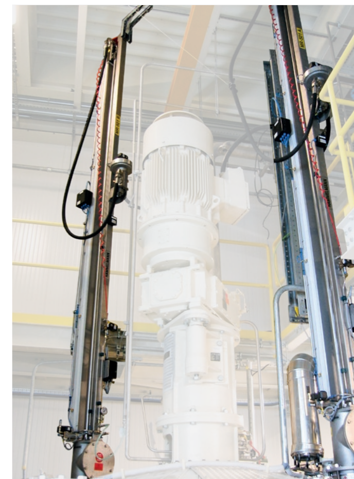
Sistema de lanza con movimiento y accionamiento neumático
