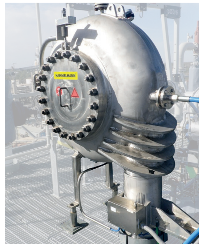
Sistema de carrete presurizado
